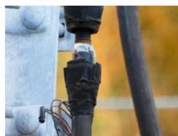
ケーブル内部露出
