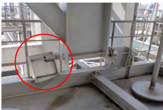
↑（茨城県鹿嶋市）【震度 6 弱地域】 ・ ボイラー天井部地震受け金物が曲損
