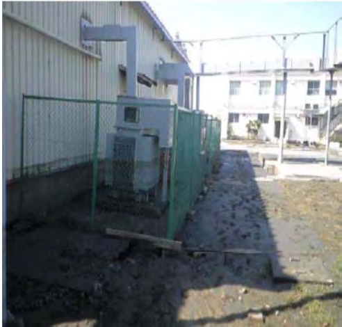
↑ (茨城県神栖市)【震度 6 弱地域】 ・ 6kV 所内電源供給設備 ・ 液状化により傾斜した変圧器
