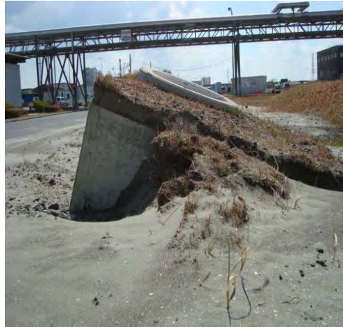
↑ (茨城県神栖市)【震度 6 弱地域】 ・ 液状化で隆起したマンホール
