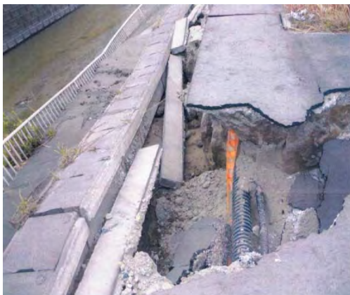
← (茨城県神栖市)【震度 6 弱地域】 ・ 液状化により地盤が陥没し露出したケーブル
